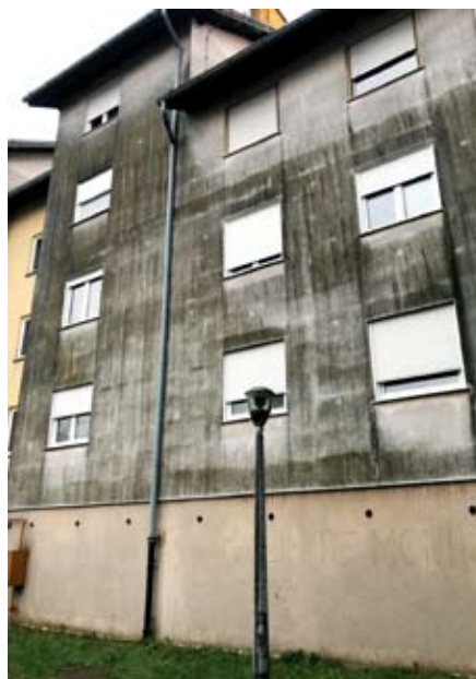
Ne dopustite da vam fasada izgleda ovako
